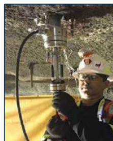
Скважинный экстензометр со снятой крышкой электрической головки устанавливается в потолок подземной выработки.
